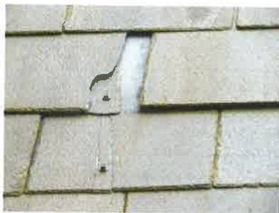
Ubytki w łupku z mocowaniem.
